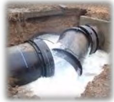
地震による管路被害(事例) (東日本大震災)
