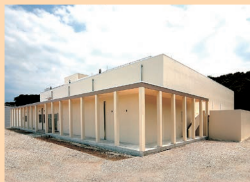
長浜雨水ポンプ場
