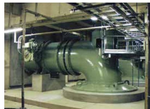
口径1,500mmポンプ（一宮雨水ポンプ場）
