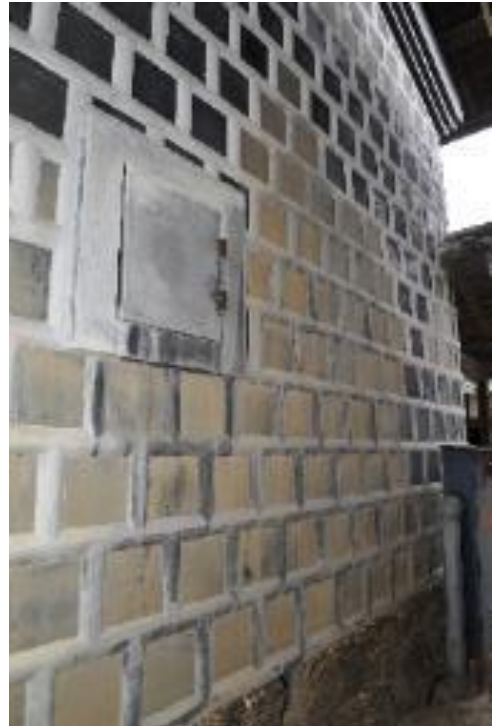
写真 2-23 道具倉 南側壁面の汚損
