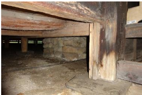
写真 2-14 主屋 床下浸水の痕跡
