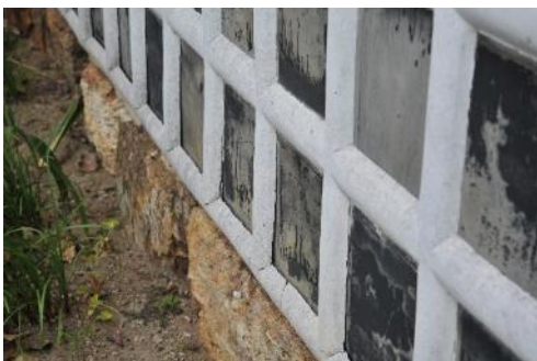
写真 2-31 米倉 海鼠壁の漆喰浮き, 割れ
