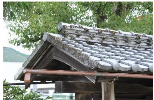
写真 2-39 裏門 棟・ケラバ漆喰の割れ
