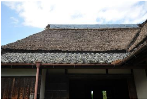
写真 2-8 主屋 茅葺の摩滅と軒積の破損
