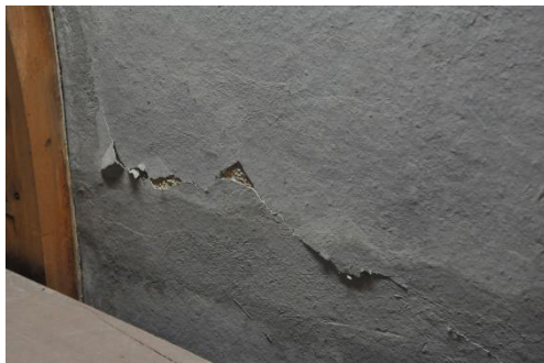
写真 2-25 道具倉 2階壁面の亀裂
