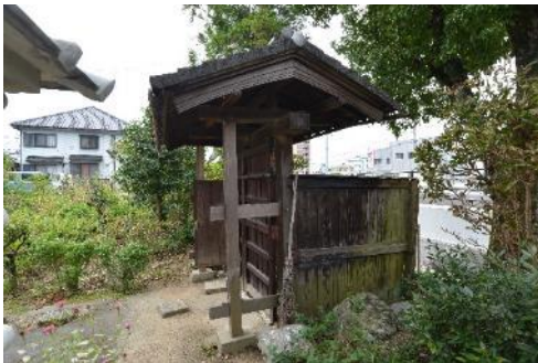
写真 2-38 裏門 板塀の腐朽
