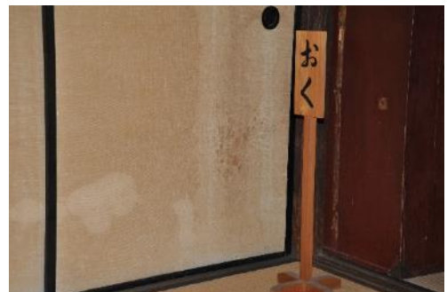
写真 2-15 主屋 襖の劣化と獣害
