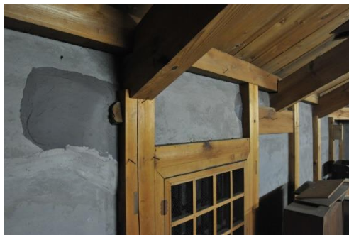
写真 2-24 道具倉 2階壁面の補修痕
