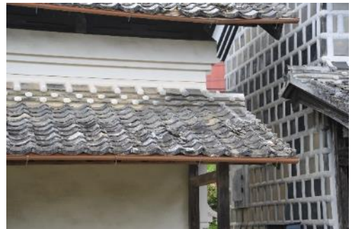
写真 2-30 米倉 瓦の破損・落下
