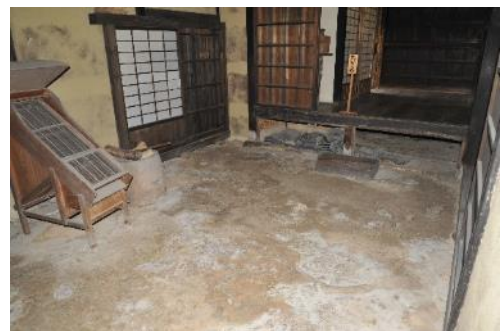
写真 2-13 主屋 土間叩きの骨材が露出
