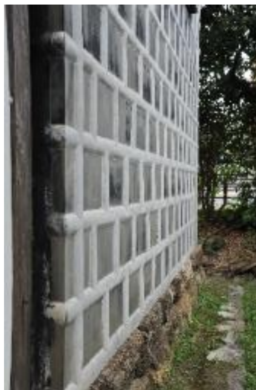
写真 2-20 道具倉 北側壁面のはらみ出し
