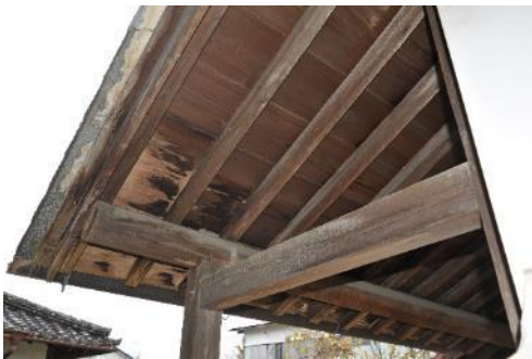
写真 2-29 米倉 下屋広小舞の腐朽
