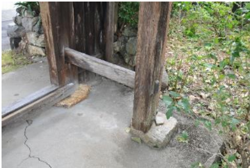
写真 2-35 表門根 継部分の腐朽
