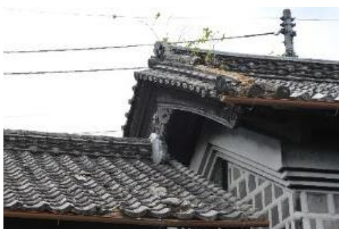
写真 2-18 道具倉 瓦の破損・落下と雑木
