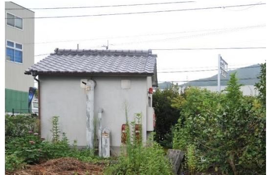
写真 1-22 (i) ポンプ室
