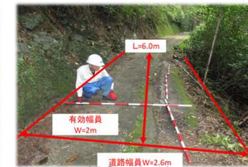
道路幅員W=2.6m 朝倉39号線 路肩欠損 L=6m
