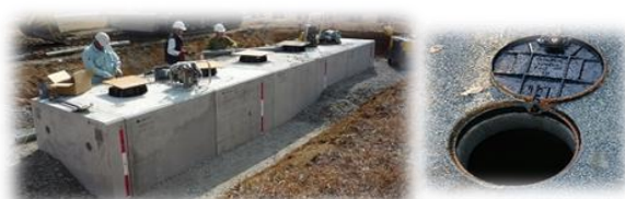
くみ取り式マンホールトイレ (コンクリート製) の例
