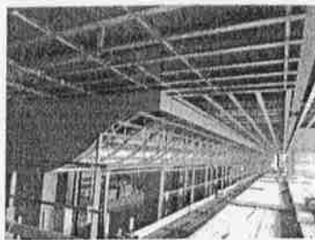
2階テラス天井は、ゆるやかなカーブを描いています。この天井にも木材が使用されます。
