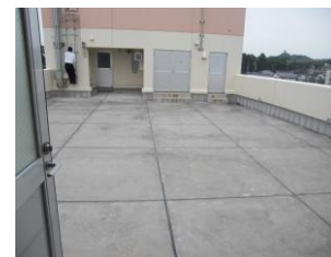
屋上避難スペース
