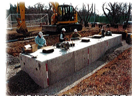
くみ取り式マンホールトイレの整備
