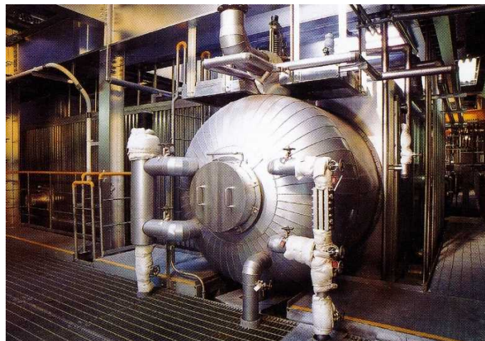
ボイラ（※資料は高知市提供）
