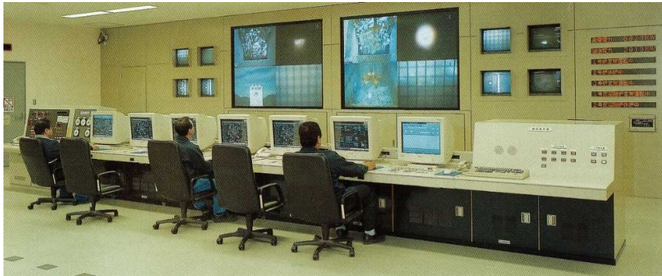
中央監視制御室（※資料は高知市提供）
