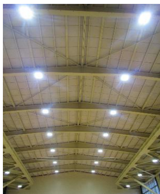
学校体育館に設置したLED照明
