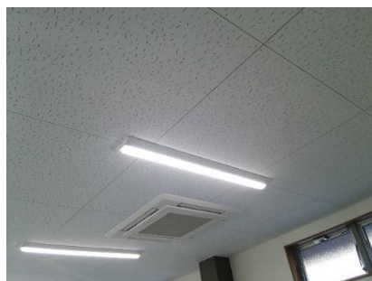
省エネ補助金を活用して入れ替えた LED照明と空調
