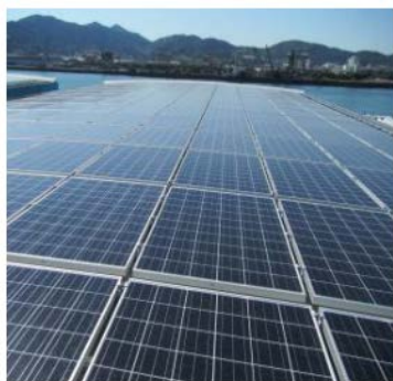
卸売市場に設置した太陽光発電設備
