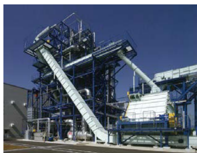
木質バイオマス発電所
