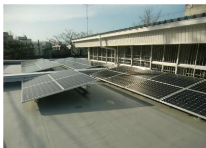
学校に設置した太陽光発電設備
