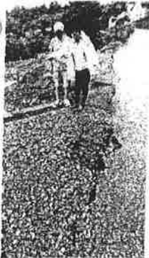
高1の土砂流出の原因となった、市道の路肩の崩落現場。写真は応急処置で土を盛ったところです。
