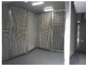
10F 梯子車用放水施設
