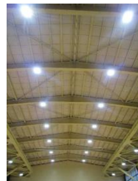
学校体育館に設置したLED
