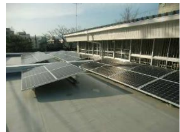
学校に設置した太陽光発電設備
