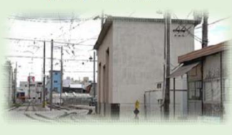
【写真】後免変電所
