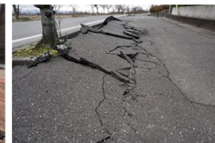
①② ■令和6年能登半島地震における被害と対応 国土交通省 令和6年6月
