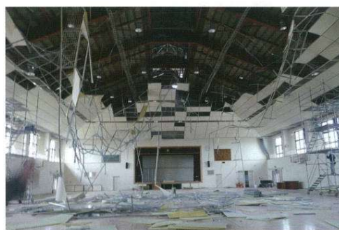
体育館における天井の脱落の様子 出典：（一財）日本建築防災協会
