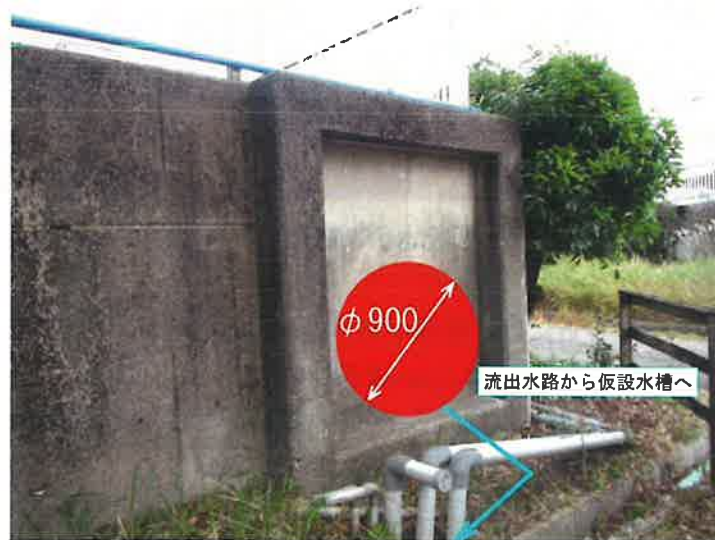
写真 最終沈殿池流出部
