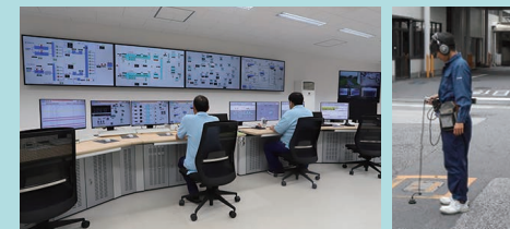
針木浄水場中央監視室
