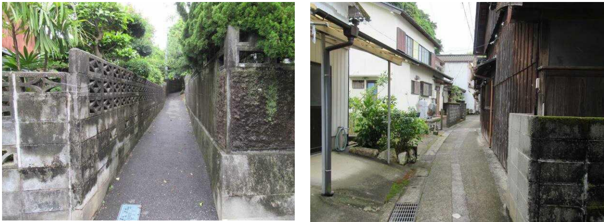
図 6-4 倒壊のおそれのあるブロック塀の例
