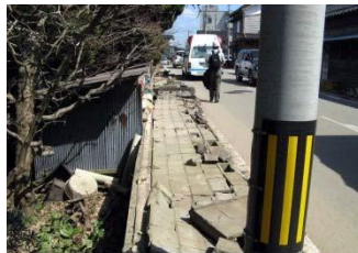
ブロック塀倒壊
