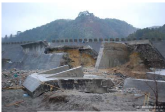
防波堤の崩壊
