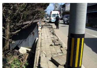
ブロック塀倒壊
