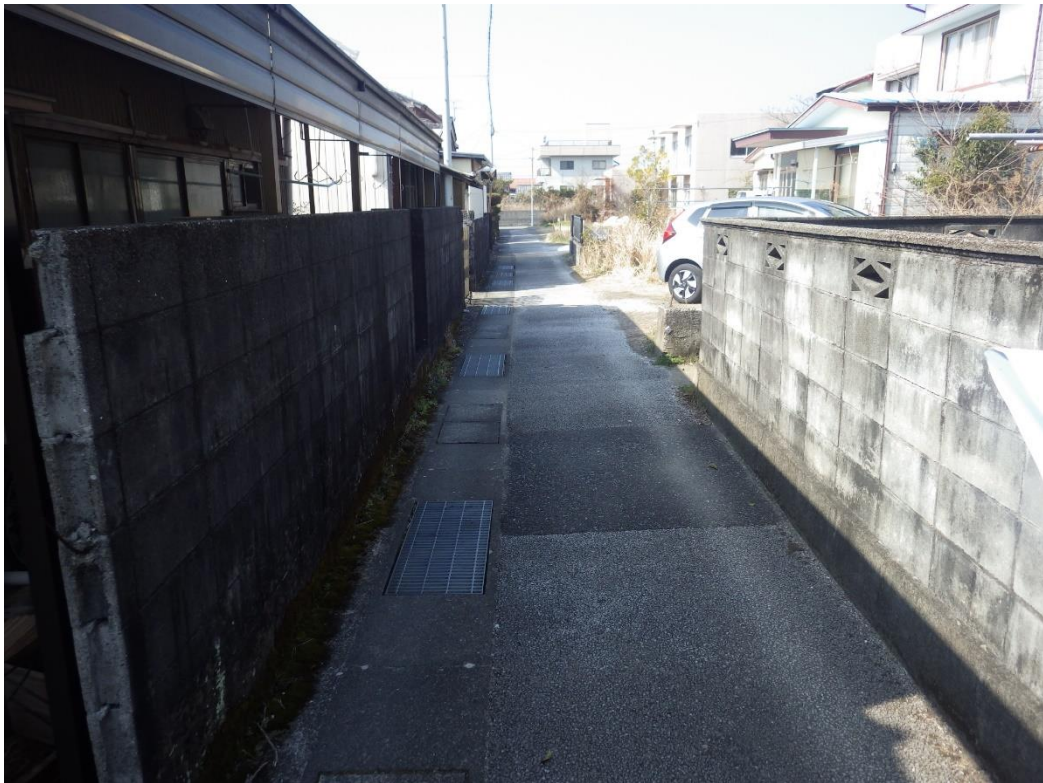
図 24 倒壊のおそれのあるブロック塀
