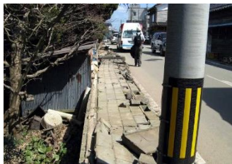
ブロック塀倒壊
