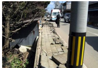
ブロック塀倒壊
