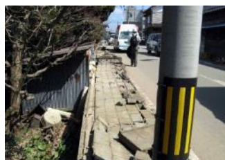
ブロック塀倒壊
