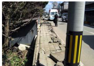
ブロック塀倒壊
