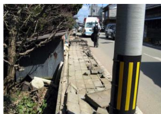
ブロック塀倒壊
