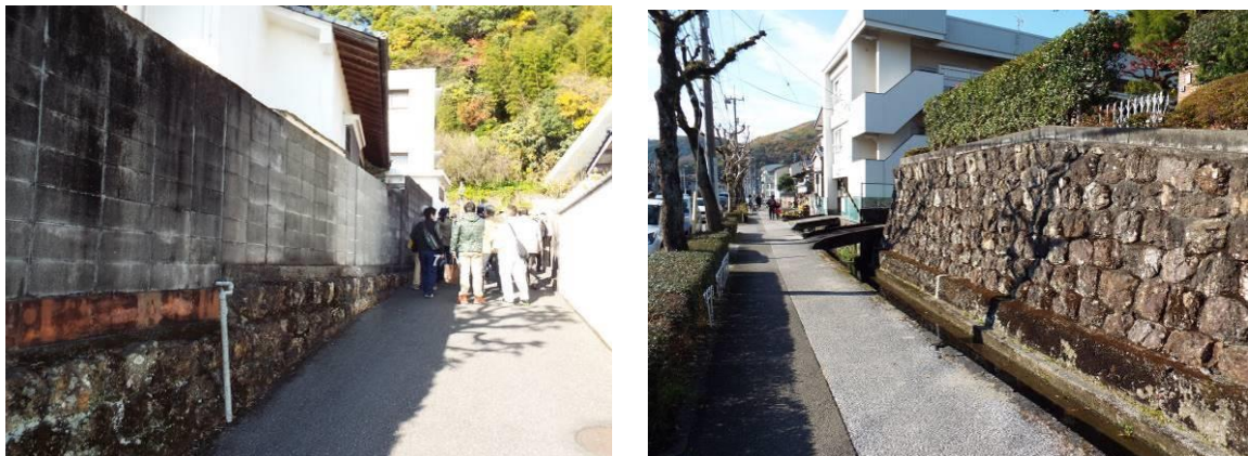
倒壊のおそれのあるブロック塀と転落のおそれがある水路の例
