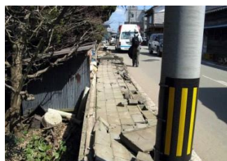
ブロック塀倒壊
