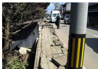
ブロック塀倒壊
