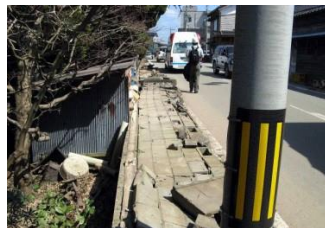
ブロック塀倒壊
