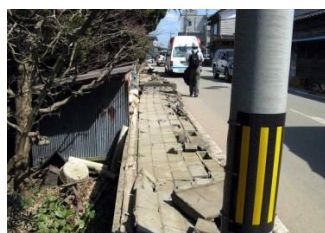
ブロック塀倒壊
