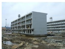
津波浸水後、地盤沈降により周辺が浸水した石巻市内の住宅
