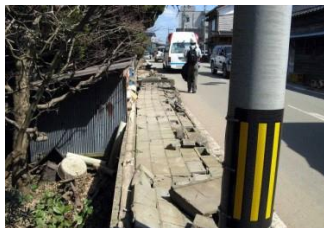
ブロック塀倒壊
