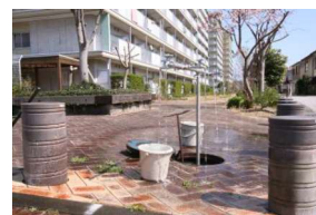
応急給水栓 (市内60か所に設置)
