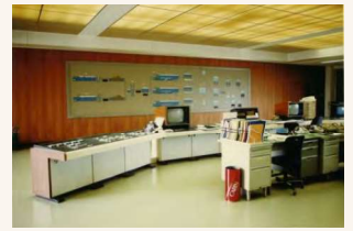
中央コントロール室
