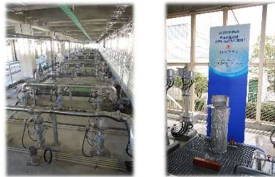
無曝気循環式水処理技術（下知水再生センター）
