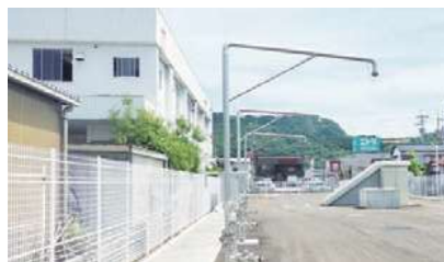
応急給水栓(朝倉配水池)
