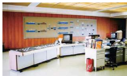
中央コントロール室
