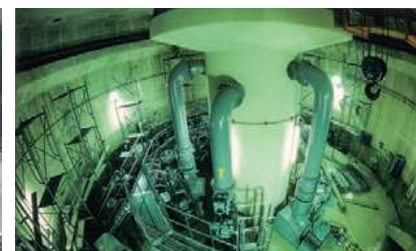
揚水所内部 ポンプ設備
