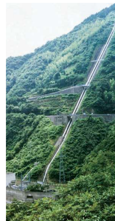
天神発電所水圧管路
