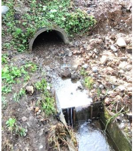
土砂でふさがった水路
