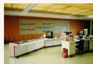
中央コントロール室
