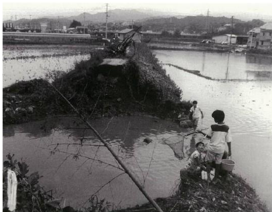
鴨部地区青果市場付近(堤防決壊の状況)
