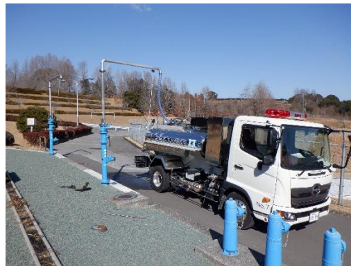
応急給水栓（計6栓）
