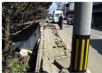
ブロック塀倒壊
