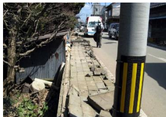
ブロック塀倒壊
