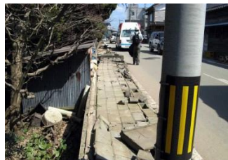
ブロック塀倒壊
