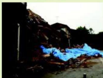
古い家屋の倒壊
