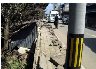
ブロック塀倒壊
