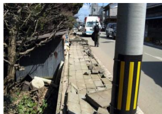
ブロック塀倒壊
