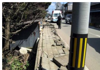
ブロック塀倒壊
