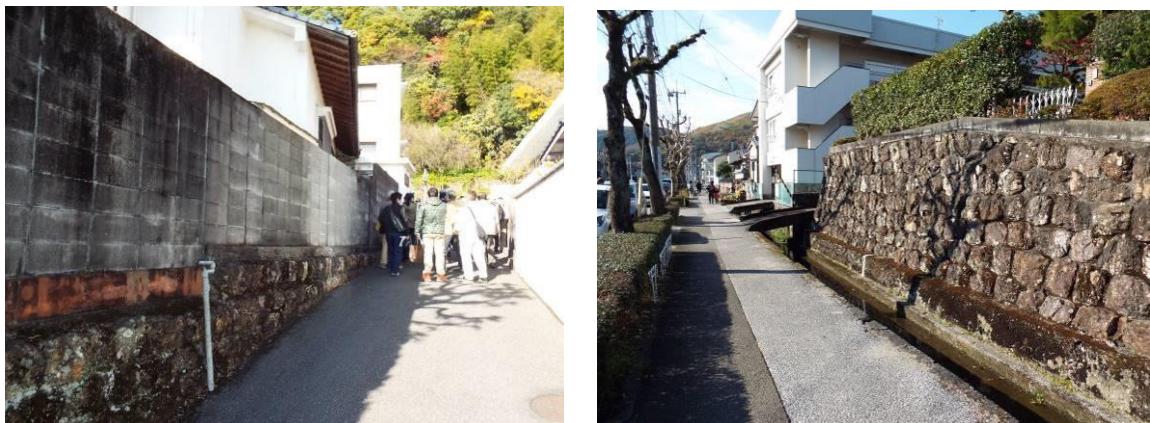
倒壊のおそれのあるブロック塀と転落のおそれがある水路の例
