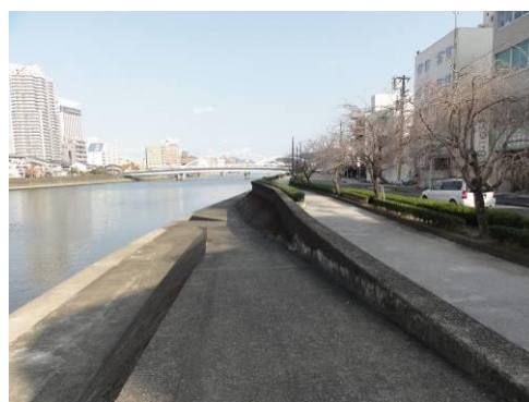
②潮江橋下流の状況
